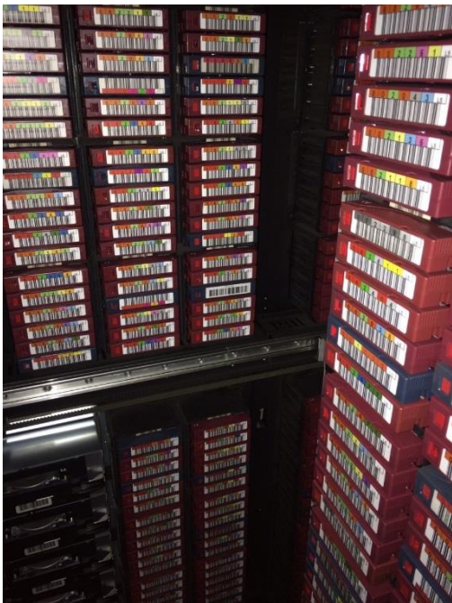
Interior de la librería automatizada de cintas donde se albergan todos los contenidos del archivo de Aragón TV gestionados por el servicio de Documentación
