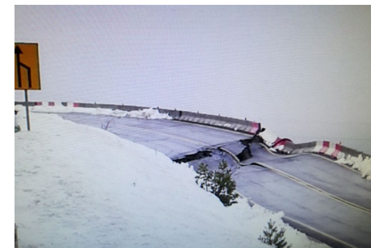
Deslizamiento en la N-330
